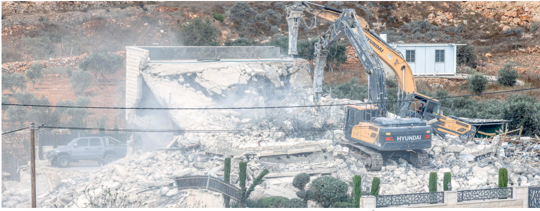
جرافات الاحتلال تهدم مبنى فلسطينياً بحجة عدم وجود ترخيص بناء، في قلنديا جنوب رام الله في الضفة الغربية المحتلة . (أ.ف.ب.)
