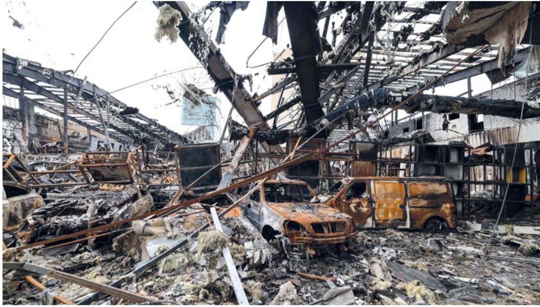
صورة تظهر حجم الأضرار التي لحقت بمركز خدمة سيارات في شرق طهران جراء هجوم صاروخي
