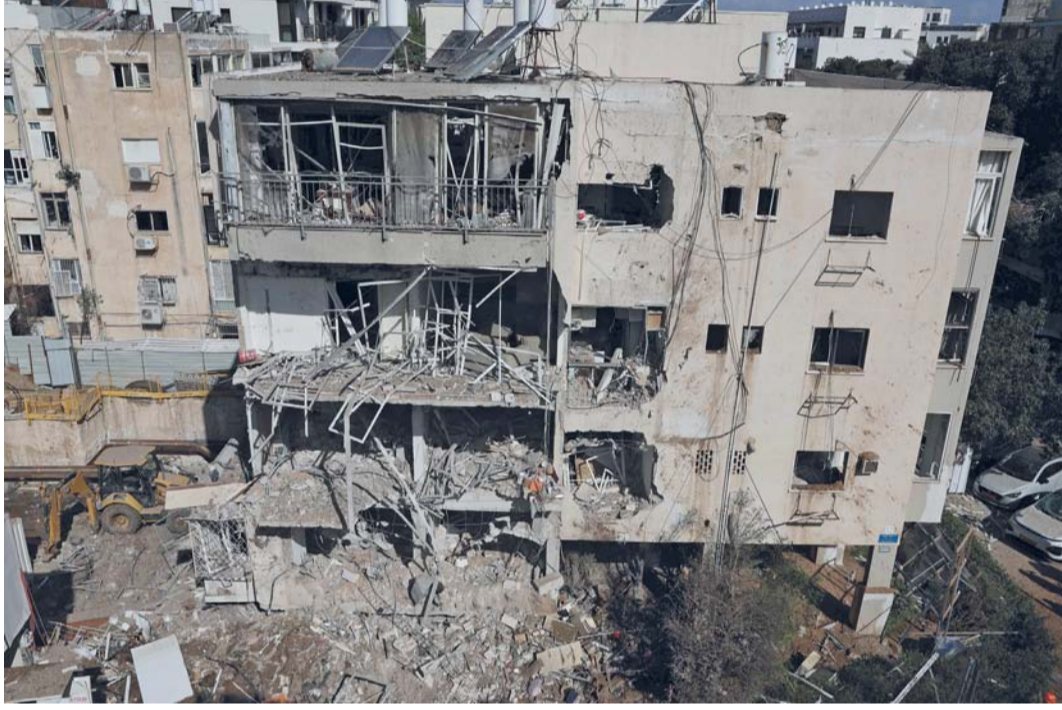
مبنى متضرر في موقع هجوم صاروخي إيراني على تل أبيب .
