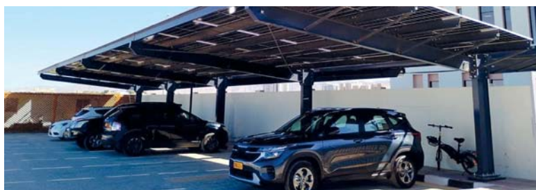
■ المشروع يسهم في خفض التكاليف التشغيلية للكهرباء
