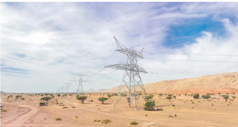
■ المشروع يسهم في ضمان استقرار وسلامة وموثوقية شبكة الكهرباء
