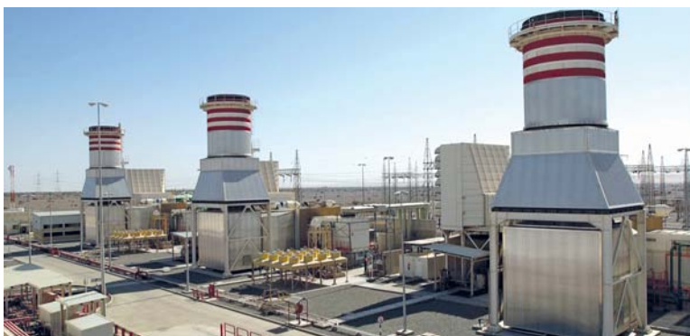
المشاريع ستعزز بشكل كبير من موثوقية وأمن إمدادات الكهرباء في شبكة الكهرباء الرئيسية
